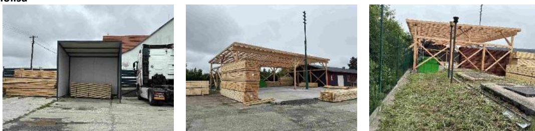
Prístrešok bez súp.č., parc.č. 258/2, k.ú. Holiša, rozostavaný pístrešok bez súp.č., parc.č. 106/10, k.ú. Holiša
