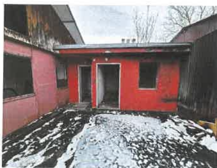
Kotolňa na p.č. 1575/8 exteriér a interiér
